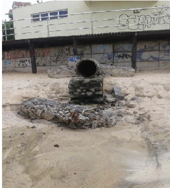
Figura 5: Tubulação de drenagem em frente aos restaurantes da orla ( 22^{\circ}24'22''S e 41^{\circ}47'58''W ) na Praia dos Cavaleiros (Foto: Miranda, L).
