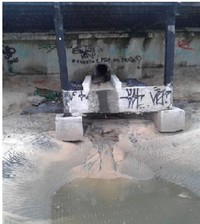
Figura 4: Tubulação de drenagem em frente a um hotel ( 22^{\circ}24'29.1''S e 41^{\circ}48'8''W ) na Praia dos Cavaleiros (Foto: Miranda, L).
